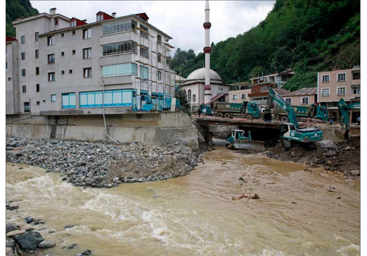
Meydana gelen felakette 11 vatandaş hayatını kaybederken, onlarca bina yıkıldı, yüzlercesi de hasar gördü.
